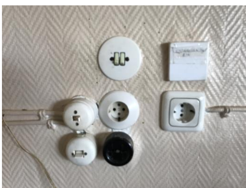
Elektroinstallation im Festsaal
