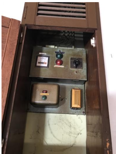
Elektroinstallation im Festsaal
